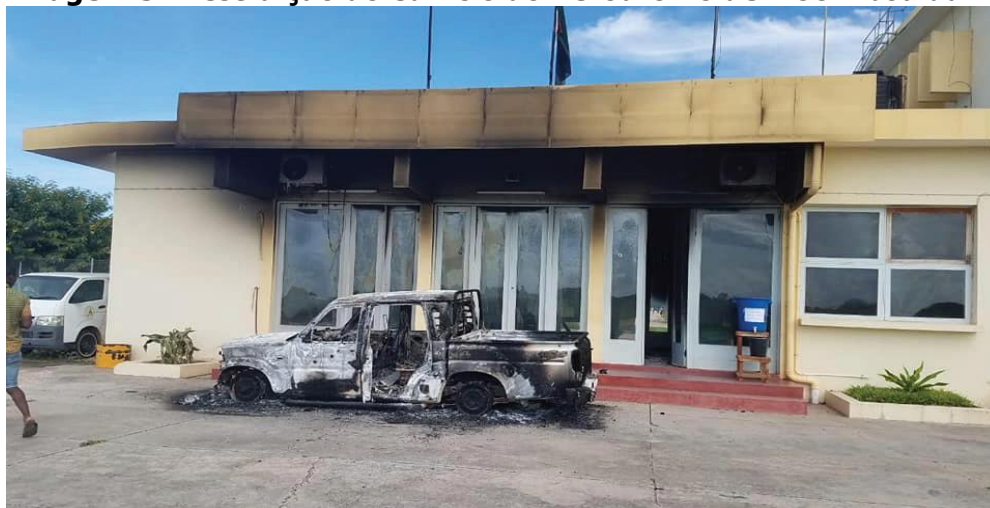
Imagem 5- Destruição do edifício do Aeródromo de Mocímboa da Praia
